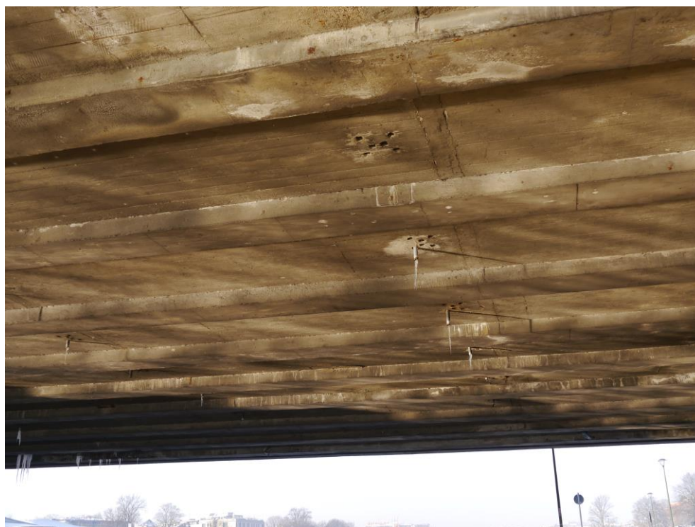
Fot.2.18 Stan ogólny spodu przęsła od strony ul. Dietla
