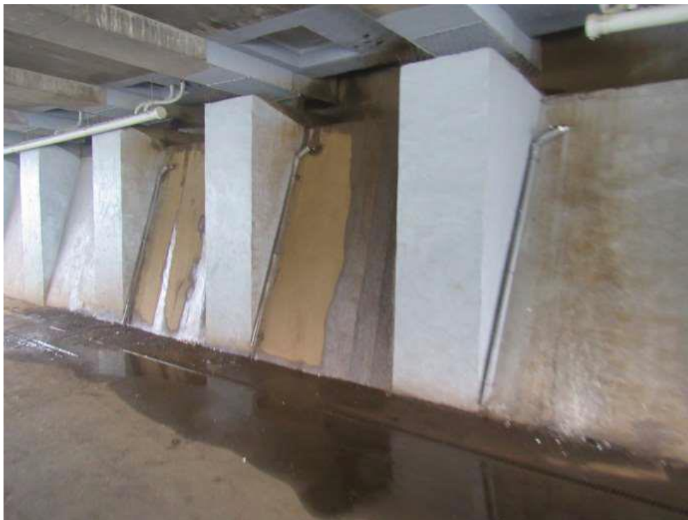
Fot.2.23 Przecieki przez dylatację na przyczółku od strony ul. Dietla
