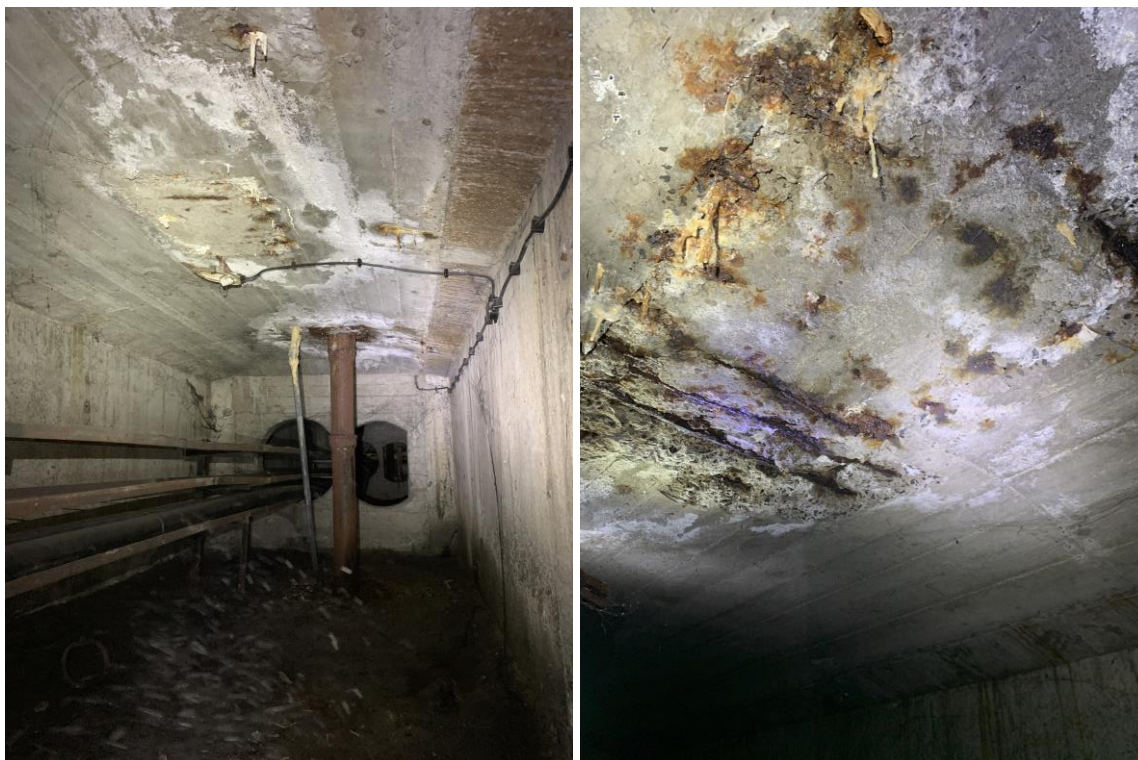
Fot.2.11 Uszkodzenia izolacji i płyty pomostu w kanale I
