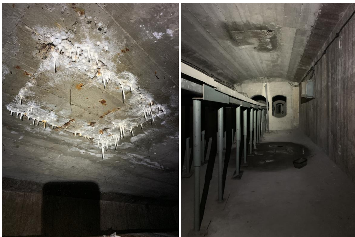
Fot.2.16 Uszkodzenia płyty w miejscach otworów technologicznych
