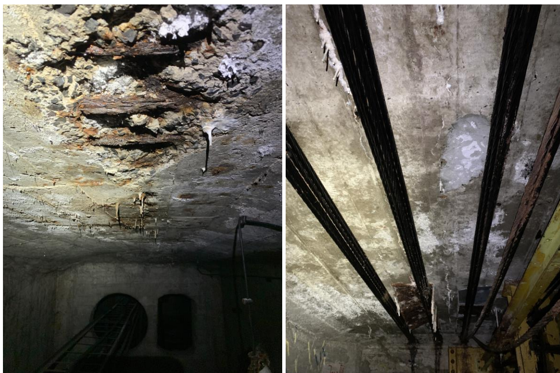
Fot.2.14 Typowe uszkodzenia płyty w kanale IX w części przęsłowej (strona lewa) i w części nad filarem (strona prawa)
