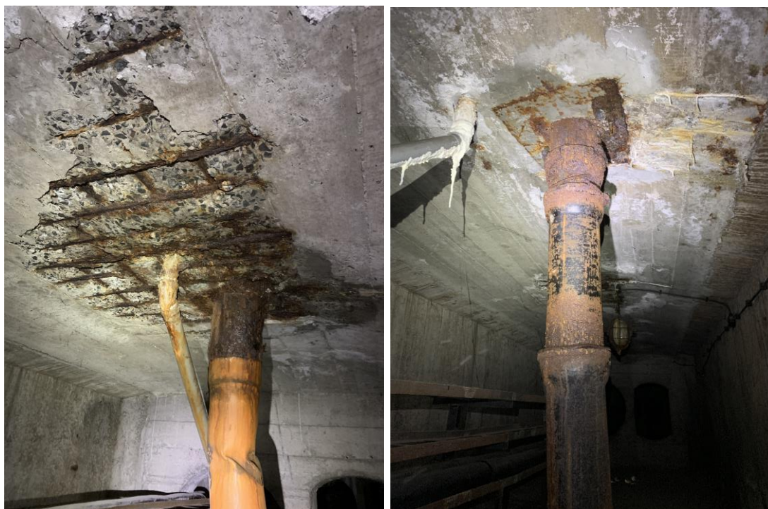
Fot.2.9 Typowe uszkodzenia w miejscu osadzenia rur wpustowych i sączków
