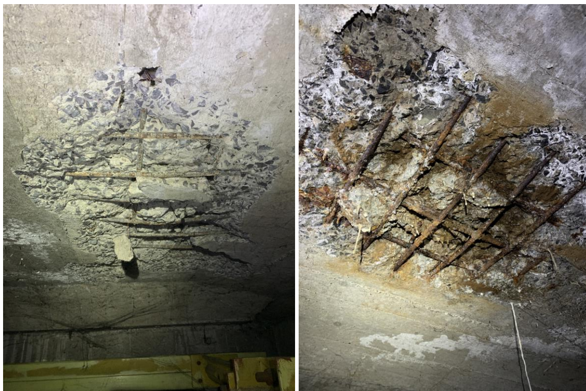
Fot.2.15 Uszkodzenia płyty w kanale VI pod torowiskiem tramwajowym
