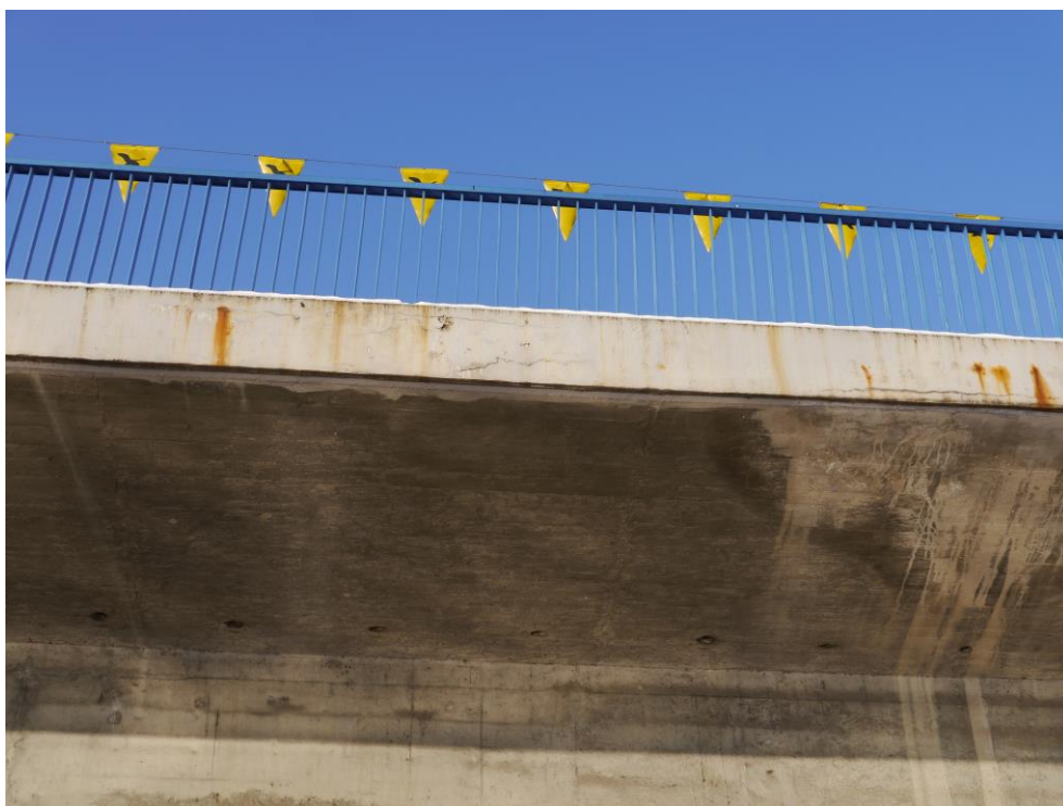
Fot.2.8 Ślady korozji zbrojenia i spękania w gzymsach oraz zacieki na wsporniku podchodnikowym (widok od dolnej wody)
