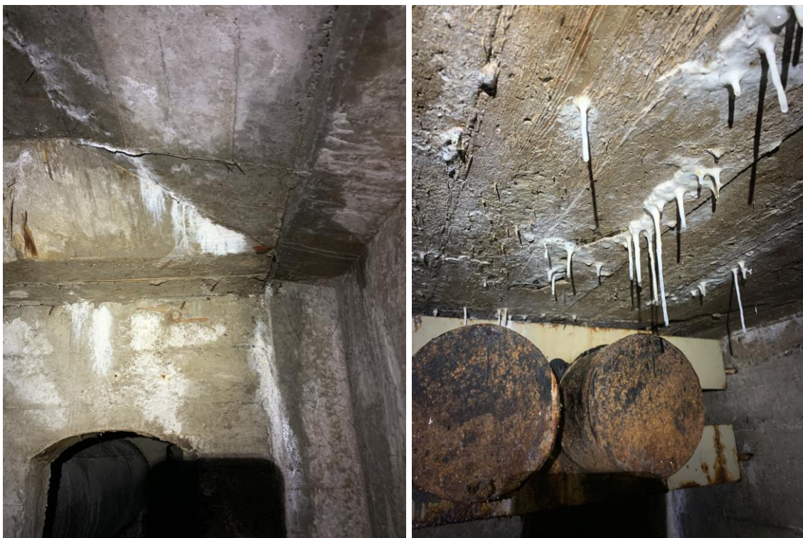
Fot.2.12 Przecieki na styku płyty z poprzecznicą i belką (po lewej) oraz nad blokiem kotwiącym sprężenie zewnętrzne (po prawej)
