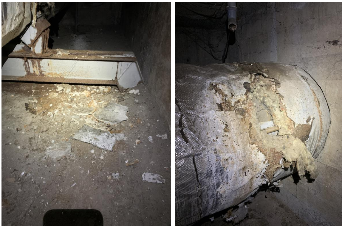
Fot.2.35 Korozja podpory rurociągu sieci ciepłowniczej w kanale IV (strona lewa), uszkodzenia powłoki termoizolacyjnej rurociągu sieci ciepłowniczej w kanale IV (strona prawa)
