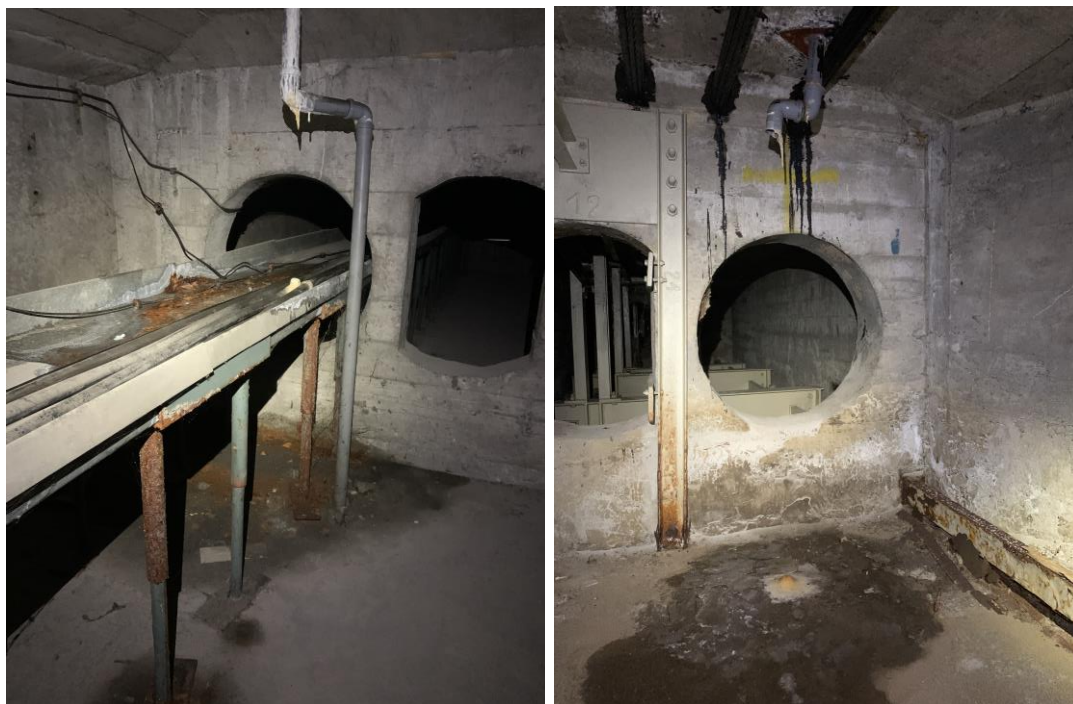
Fot.2.10 Nieszczelności na łączeniu rur spustowych sączka (po lewej). Brak rury spustowej sączka (po prawej)
