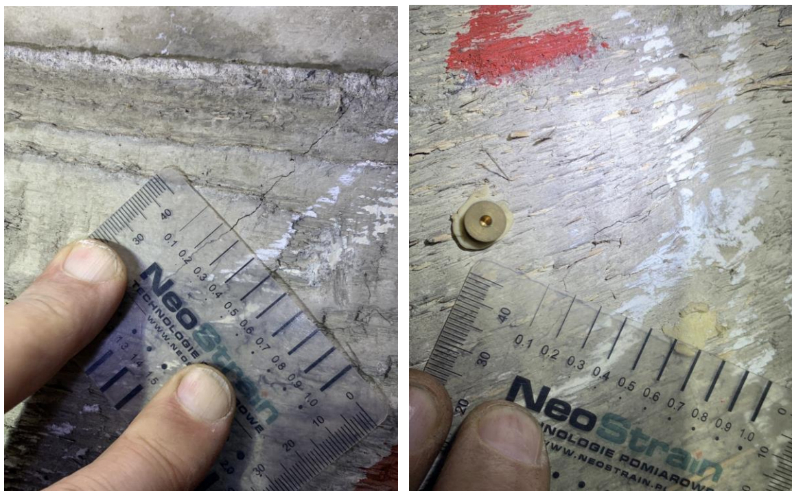
Fot.2.17 Pomiar szerokości rys ukośnych w kanale I (po lewej) i IX (po prawej)
