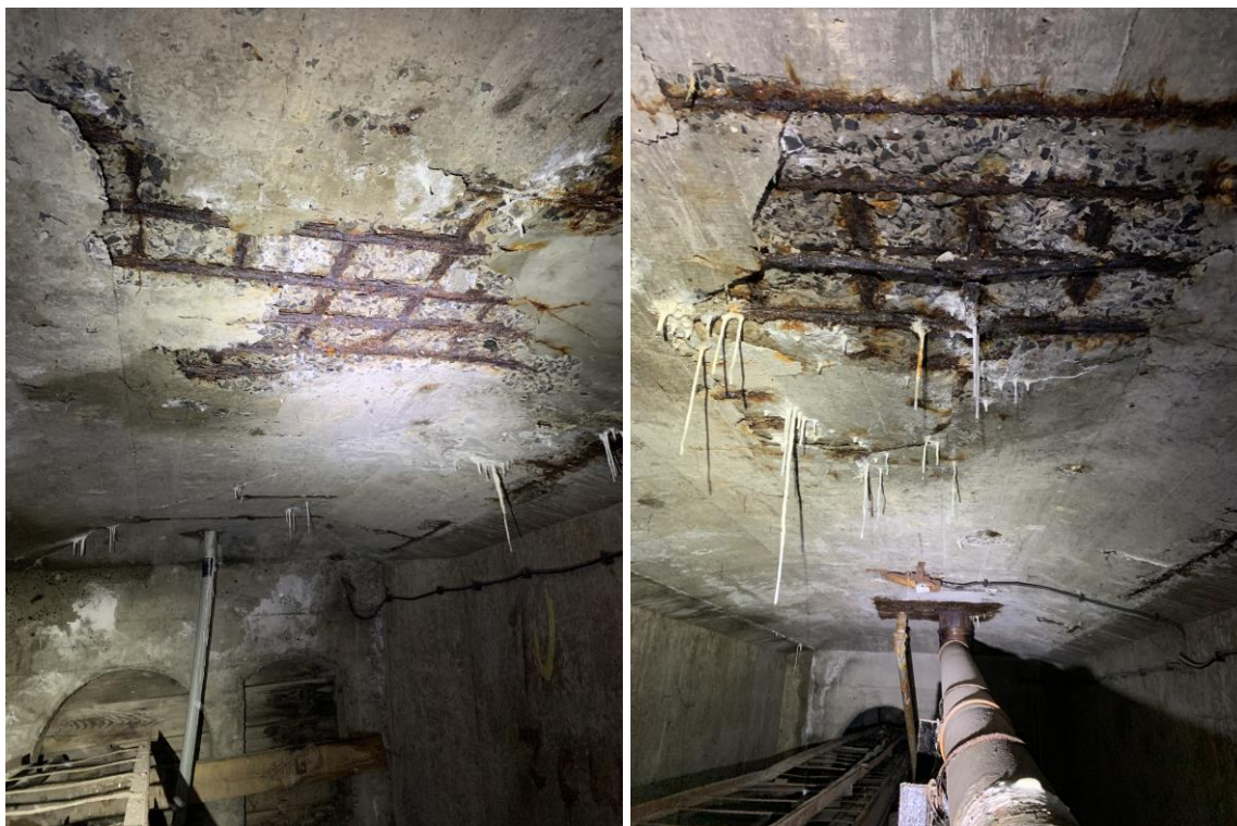
Fot.2.13 Typowe uszkodzenia płyty w kanale I w części przęsłowej
