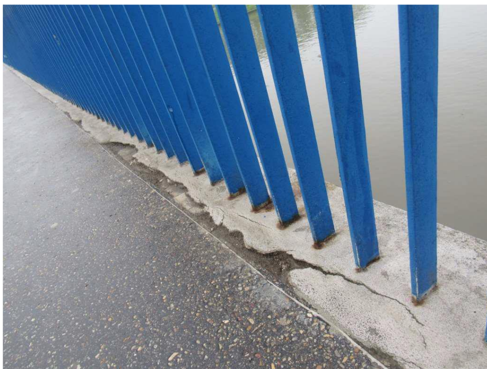
Fot.2.7 Spękania i ubytki betonu w belce podporęczowej
