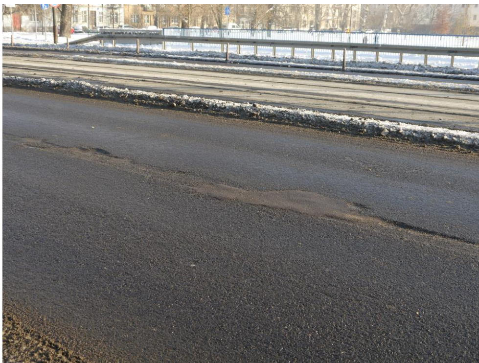
Fot.2.5 Ubytki nawierzchni jezdni od strony dolnej wody
