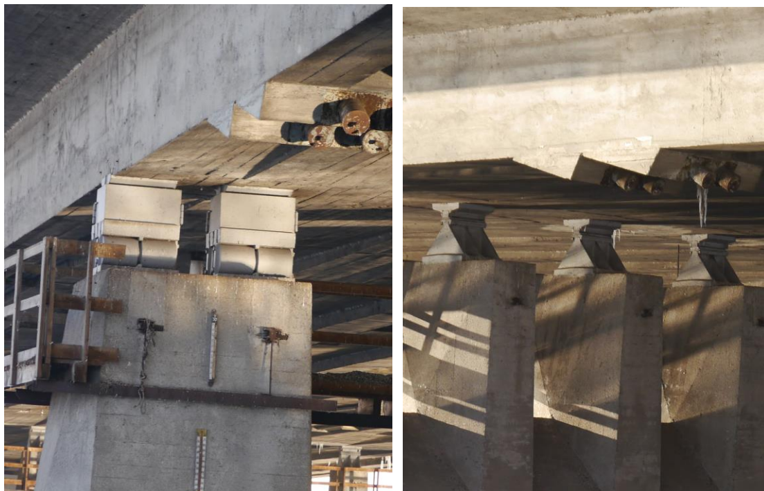
Fot.2.21 Łożyska ruchome na filarze od strony Rodna Grundwaldzkiego i stałe na filarze od ul. Dietla
