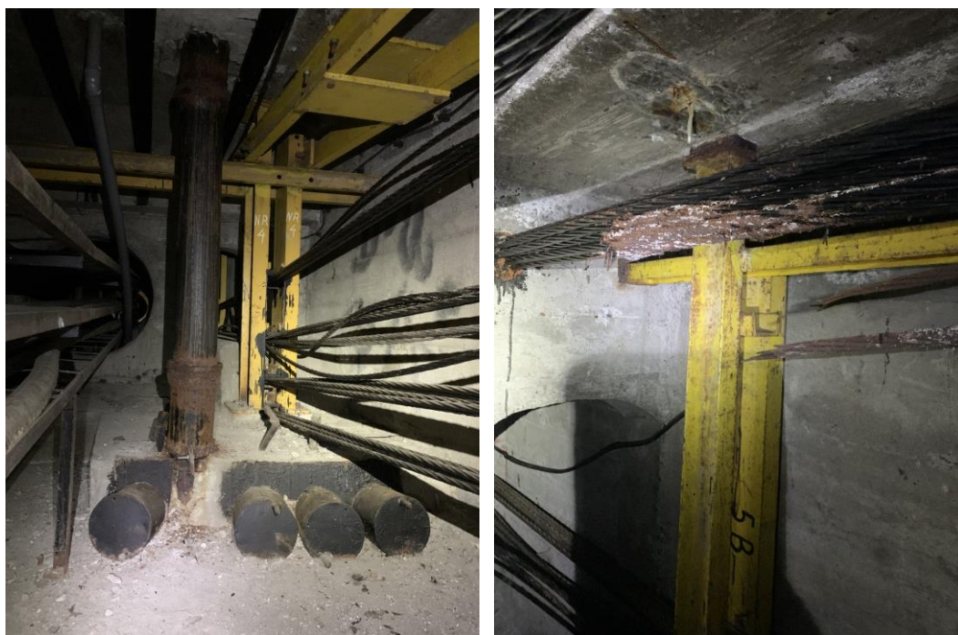
Fot.2.30 Kanał IX, podpora B: Luźne liny kabli typu (b) w dewiatorze na skutek ich zerwania w sąsiednich sekcjach, u dołu widoczne zakotwienie kabli typu (c) sprężenia przęsła środkowego mostu (strona lewa), zerwane liny kabla typu (a) (strona prawa)
