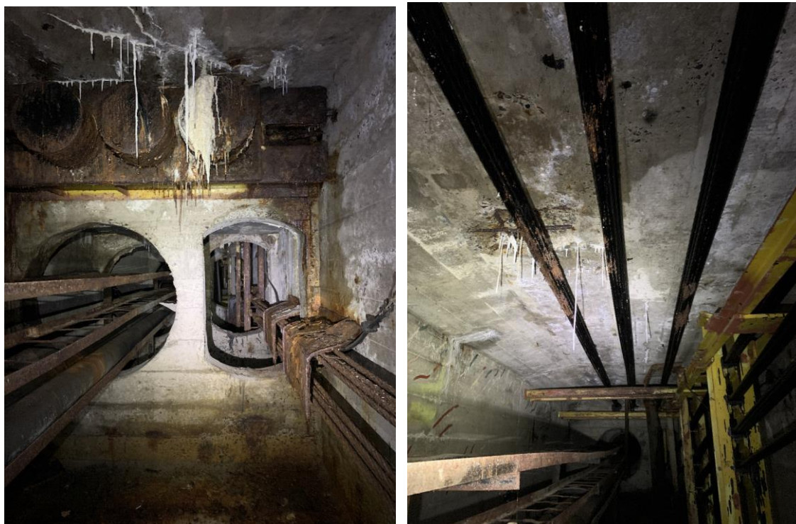
Fot.2.27 Kanał I, podpora C: Pęknięcia i przecieki w płycie pomostu i spowodowana nim zakotwień kabli typu (a) (strona lewa), Przeciek przez płytę pomostu i spowodowana nim korozja lin w kablu typu (a) (strona prawa)
