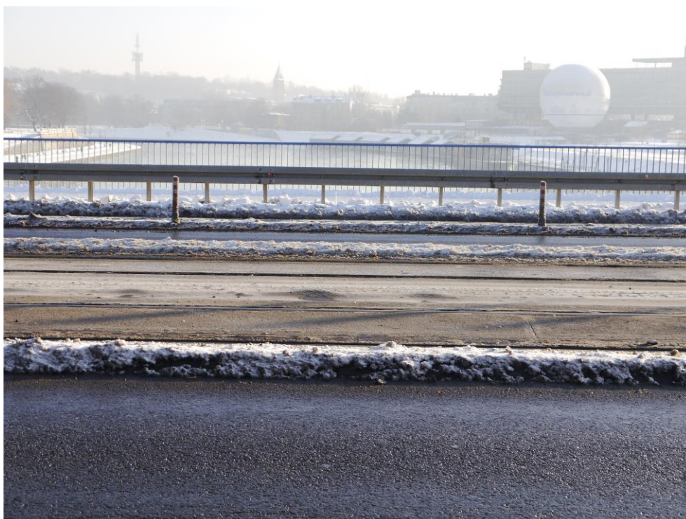
Fot.2.6 Deformacje nawierzchni torowiska
