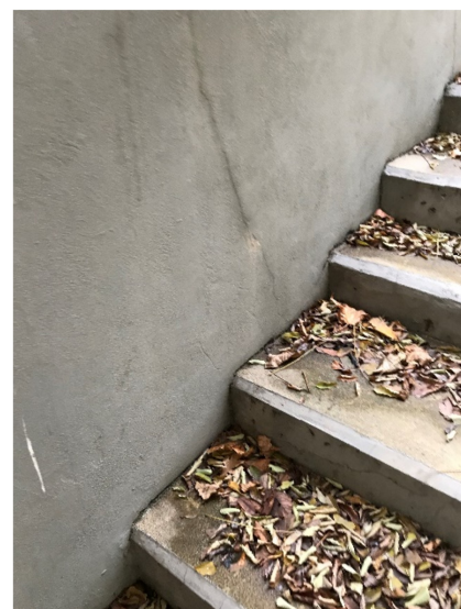
Fot.28. .Zarysowania na ścianie oporowej na elewacji zachodnio-południowej amfiteatru
