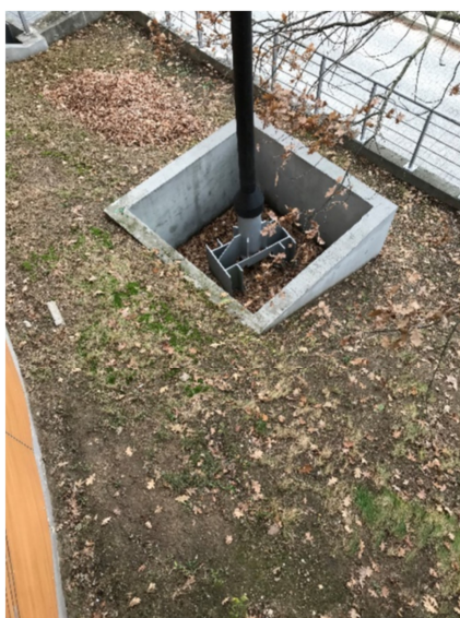
Fot.3. Zanieczyszczone węzły kosiółw liśćmi - konieczność usunięcia w celu odprowadzania wody opadowej
