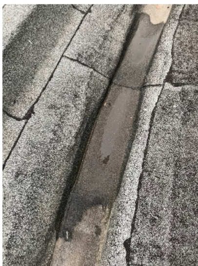
Fot.7. Miejscowe zastoiska wody z rynnie na dachu amfiteatru
