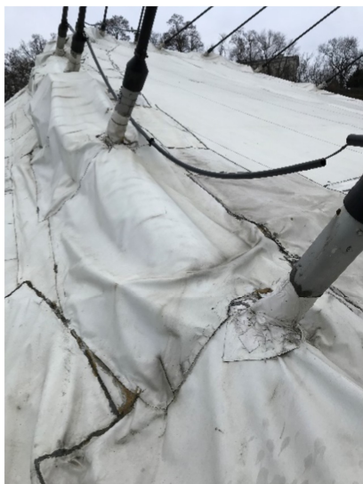
Fot.13. Oberwane okablowanie naciągach dachu amfiteatru
