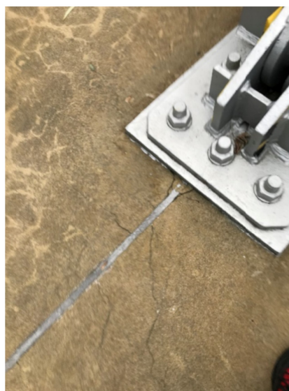
Fot. 44 .Włosowate pęknięcia posadzki z żywicy epoksydowej przy koźle. Ubytki w dylatacji.
