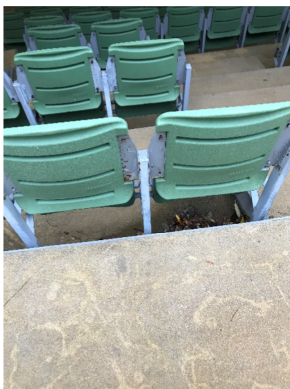
Fot.45.Zardzewiałe elementy stalowe siedzeń – do natychmiastowego malowania
