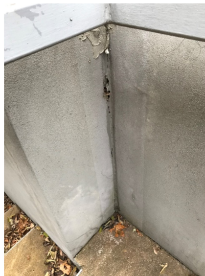
Fot.26.Uszkodzenia na dylatacji muru oporowego na stronie zachodnio-południowej
