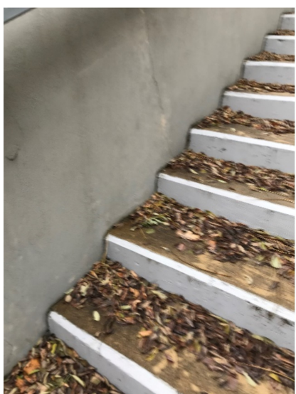
Fot.27.Zarysowania na ścianie oporowej na elewacji zachodnio-południowej amfiteatru
