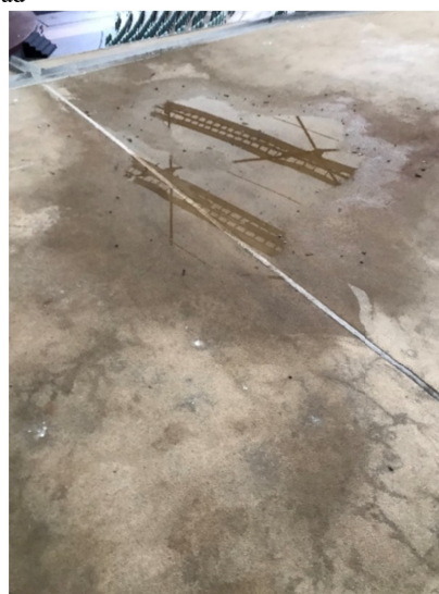
Fot.40. Zastoisko wody nad pomieszczeniami Vipów
