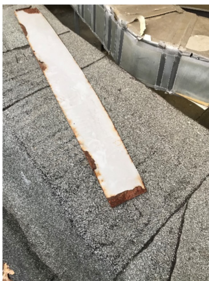
Fot.9. Zbędna blacha na dachu amfiteatru - do natychmiastowego usunięcia
