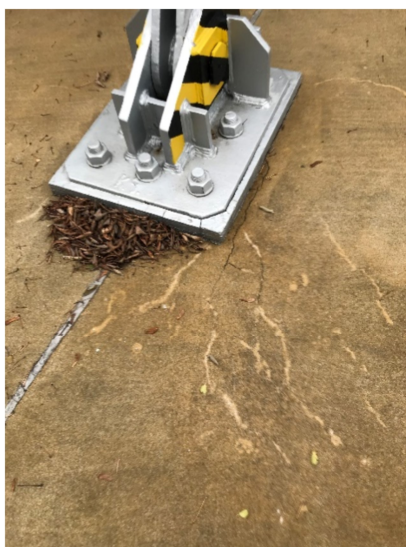
Fot.23. Drobne rysy na posadzce z żywicy epoksydowej, pęknięcia podkładu stalowego kosiół .
