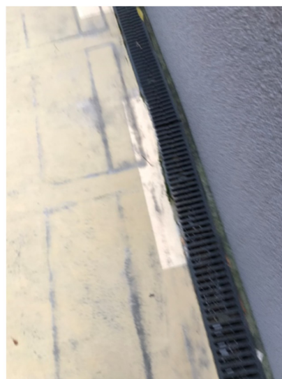
Fot.20.Uszkodzenia posadzki z żywicy epoksydowej na poziomie tarasu parteru od strony wschodniej
