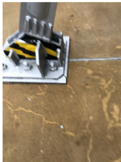
Fot.32 Drobne włosowate pęknięcia na posadzce z żywicy epoksydowej , pęknięcia płyty podkładowej kozła
