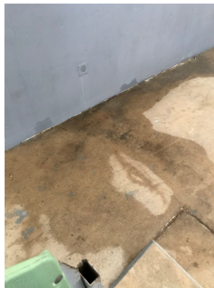
Fot.36. .Ślady wody opadowej na posadzce z żywicy epoksydowej
