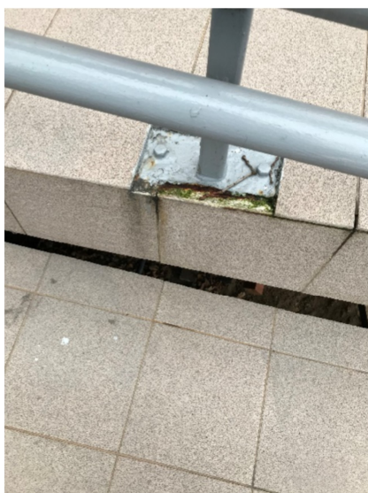
Fot.1. Uszkodzone i zardzewiałe mocowanie balustrady na pochylni dla niepełnosprawnych
