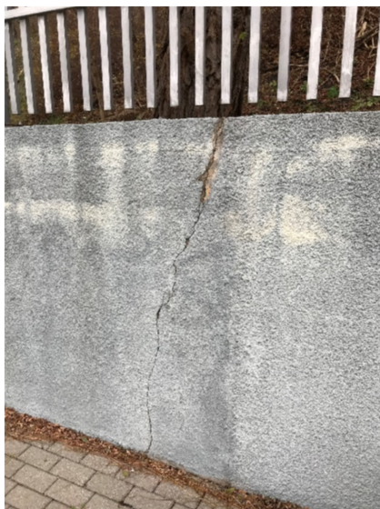
Fot.43. Zarysowania na murze oporowym korony amfiteatru
