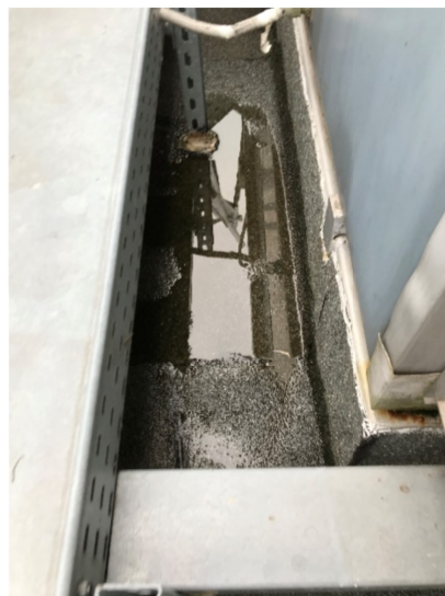
Fot.8. Miejscowe zastoiska wody na dachu amfiteatru przy urządzeniach wentylacyjnych
