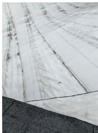
Fot.12. Powłoka dachu nad amfiteatrem - stan dostateczny (miejscowe zabrudzenia, miejscowe naprawy).
