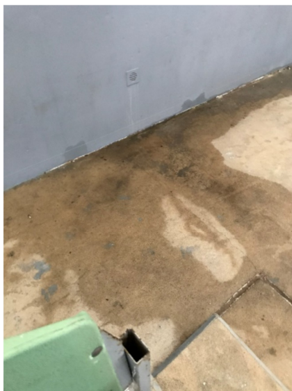
Fot.35.Ślady wody opadowej na posadzce z żywicy epoksydowej
