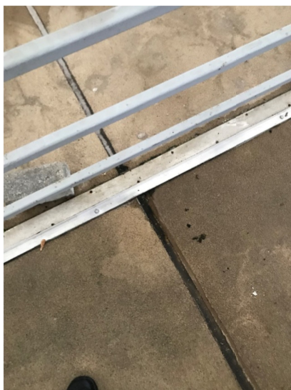
Fot.39. Ubytki masy w dylatacji
