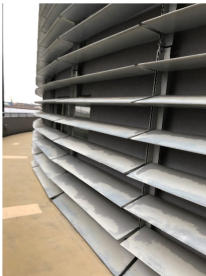
Fot.31.Ubytki powłoki malarskiej na elementach stalowych- do malowania
