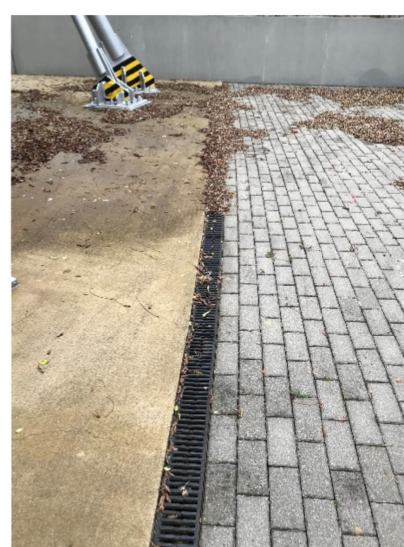
Fot.24.Zanieczyszczenia liśćmi odwodnienia liniowego na koronie amfiteatru.
