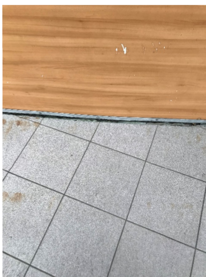
Fot.5. Szczelina między elewacją a podestem schodów wejściowych – konieczność uszczelnienia
