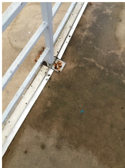
Fot.38. Zardzewiałe elementy mocowania balustrad
