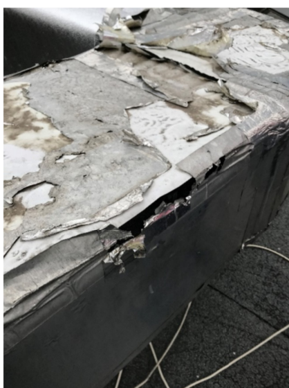
Fot.15. Uszkodzona obudowa kanałów wentylacyjnych- do naprawy w 2025 roku
