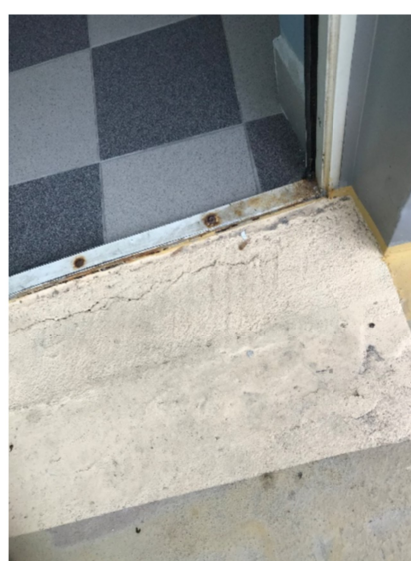
Fot.30.Zardzewiały próg w drzwiach wejściowych na taras na poziomie parteru
