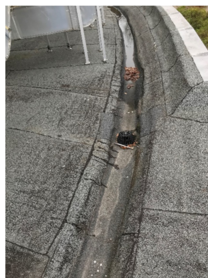
Fot. 6 Zastoisko wody w rynnie na dachu amfiteatru
