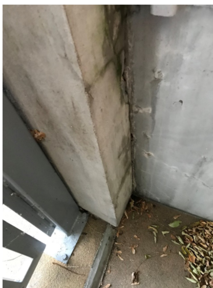
Fot.29. Uszkodzenia na dylatacji muru oporowego od strony zachodnio-południowej
