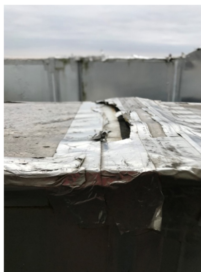
Fot.10. Uszkodzenia obudowy kanałów wentylacyjnych na dachu amfiteatru
