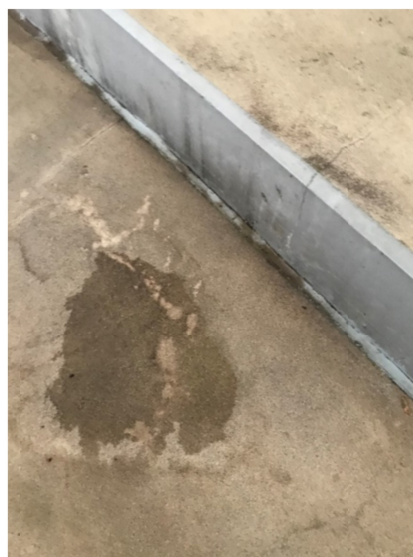
Fot.42. Pęknięcia i zarysowania włosowate na posadzce z żywicy na widowni wraz z zastoiskiem wody
