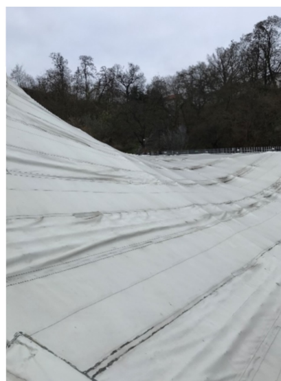
Fot.18. Powłoka dachu nad amfiteatrem - stan dostateczny ( miejscowe zabrudzenia, miejscowe naprawy)
