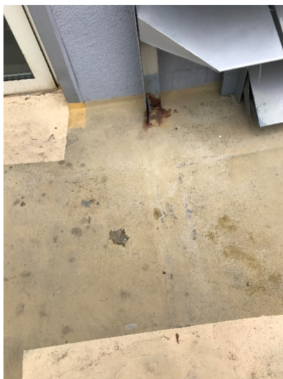
Fot.19.Ślady rdzy przy elementach stalowych mocowania elementów elewacyjnych
