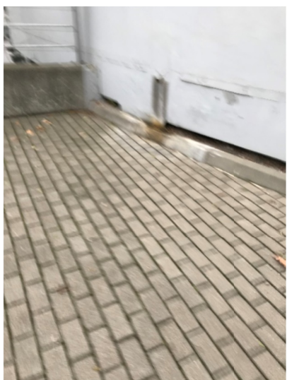
Fot.21.Odprowadzenie wody z tarasu na parterze – do wykonania prawidłowo
