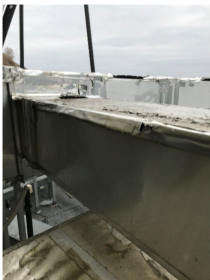
Fot.11. Uszkodzenia, ubytki obudowy kanałów wentylacyjnych na dachu amfiteatru
