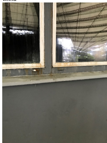
Fot.34. Zardzewiałe ramiaki stolarki okiennej w pomieszczeniach Vipów
