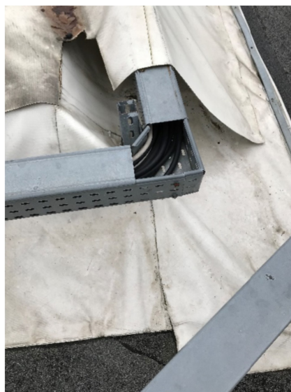
Fot.16. Brak elementów stalowych zabezpieczenia okablowania na dachu amfiteatru
