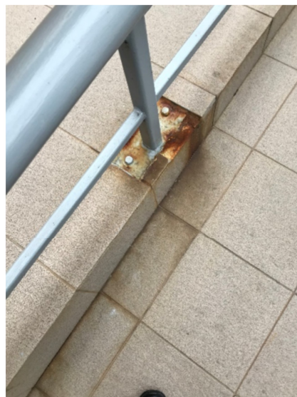
Fot.2. Kolejne uszkodzone i zardzewiałe mocowanie balustrady na pochylni dla niepełnosprawnych
