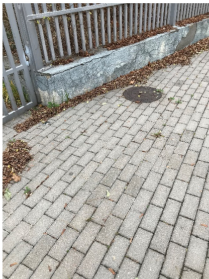
Fot.25.Odpadający tynk na ścianach oporowych na koronie amfiteatru
