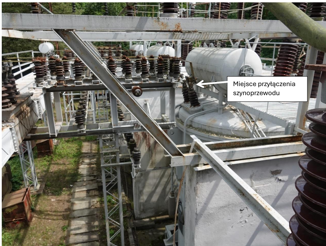
Foto 2. Połączenia transformatorów Indelve z obecnym szynoprzewodem. Miejsce przyłącza szynoprzewodu do transformatorów Indelve.
