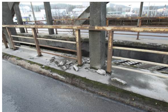
Kapa w osi o5 – zalegające opryski betonu w dźwigara łukowego
