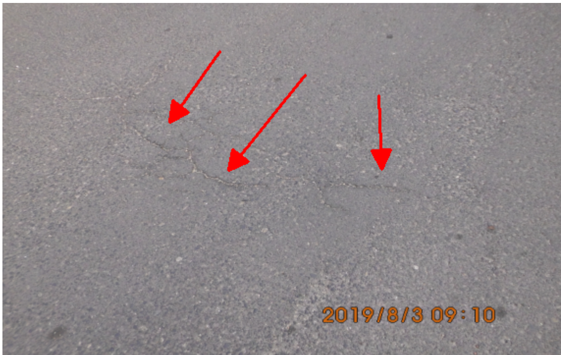
Zdjęcie 3.9 : Spękanie nawierzchni bitumicznej na moście
