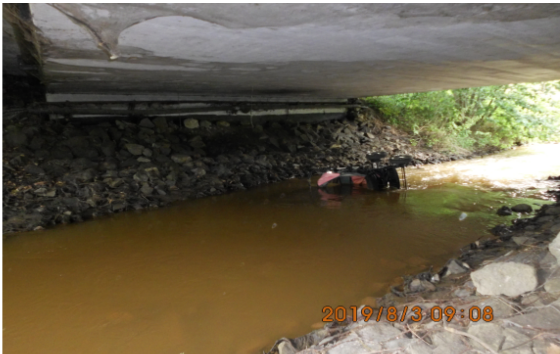
Zdjęcie 3.13 : Fragment przestrzeni podmostowej. Naprawić umocnienie skarp koryta rzeki.
