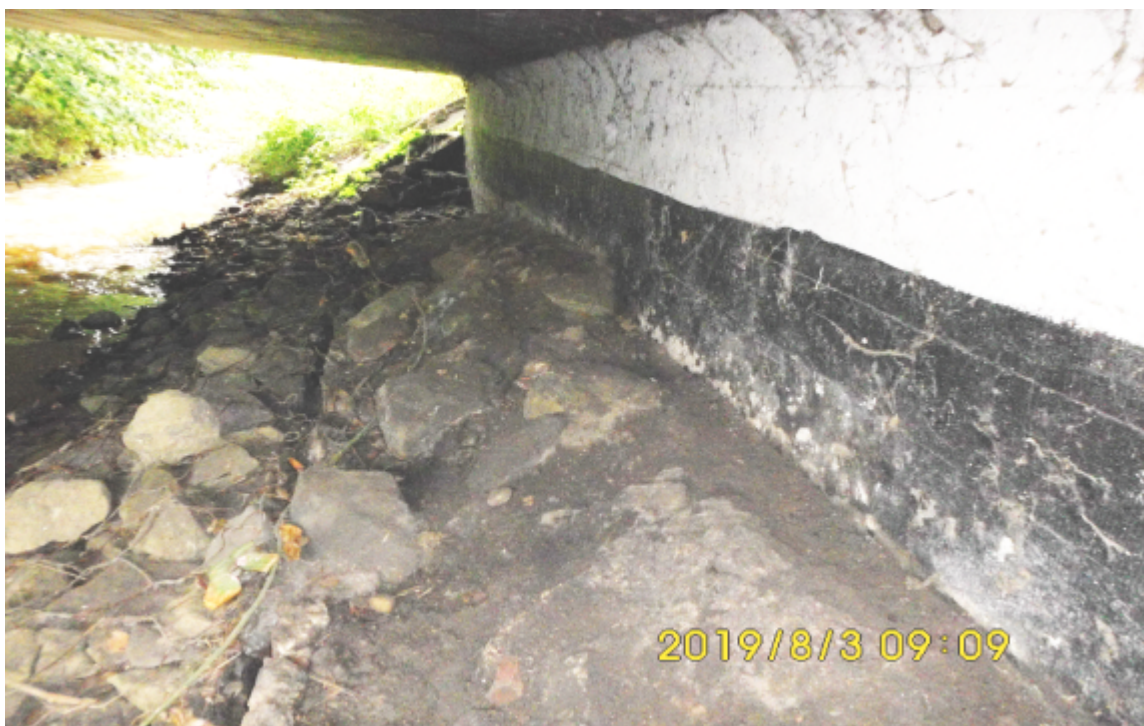
Zdjęcie 3.12 : Przestrzeń podmostowa. Naprawić umocnienie skarp.
