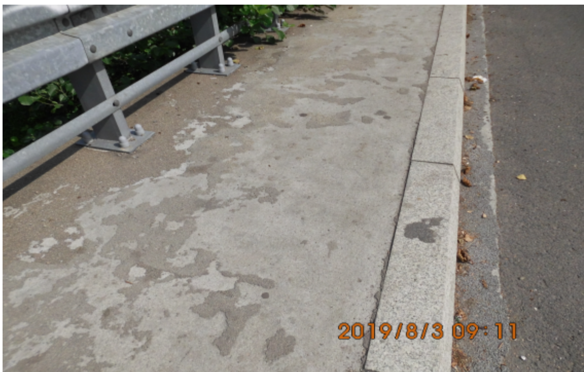
Zdjęcie 3.8: Konieczność ułożenia nowej warstwy nawierzchniowo-izolacyjnej na chodniku
