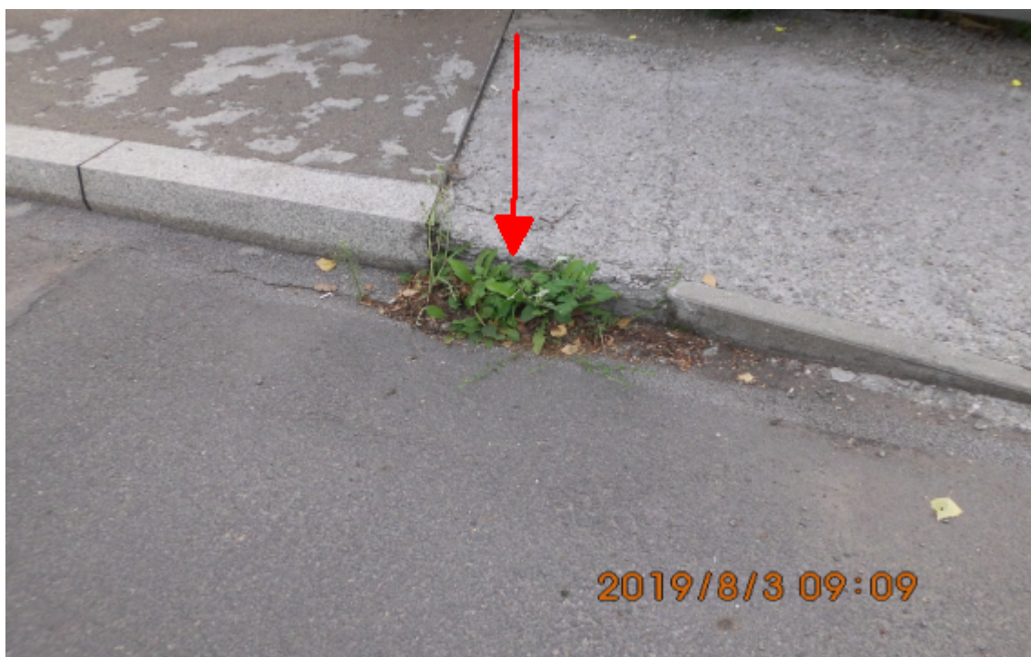
Zdjęcie nr 3.5 : Niedrożny spust wody z mostu
