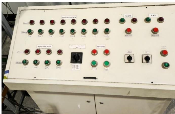
Fot. 1. Istniejący Panel sterowania umiejscowiony w hali laboratoryjnej – do demontażu.
