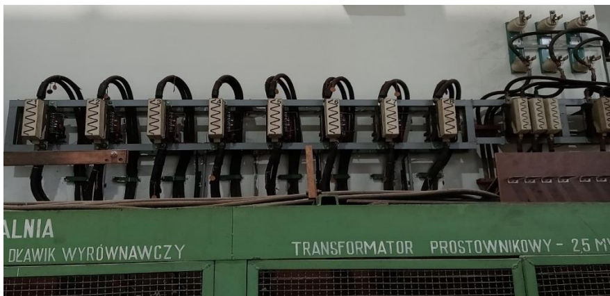
Fot. 2. Obecny stan styczników średniego napięcia.
