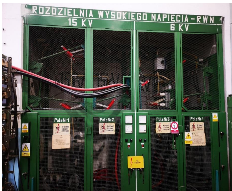
Fot. 11. Zdjęcie przedstawiające stan aktualny rozdzielni SN w budynku Laboratorium
