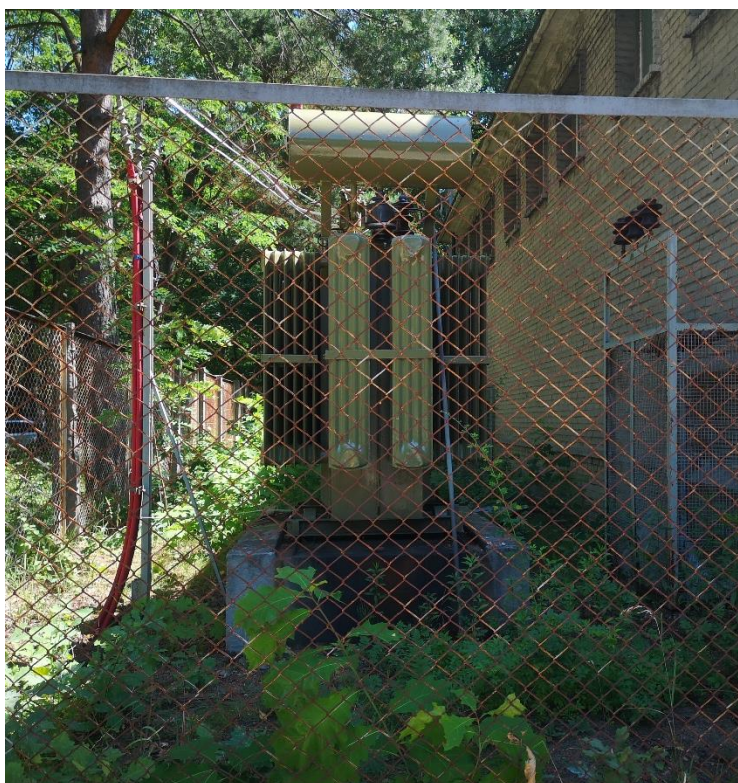
Fot. 6. Aktualny stan transformatora napowietrznego.
