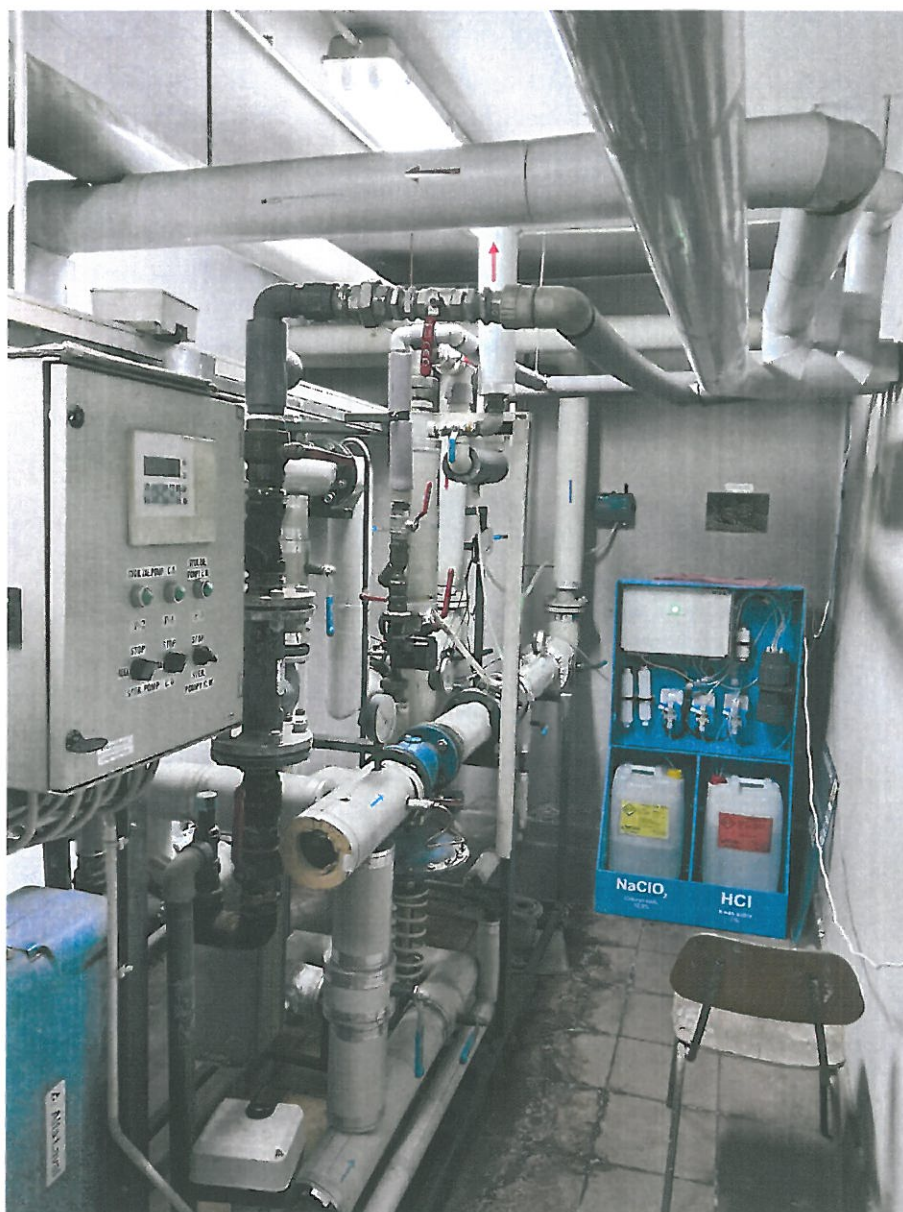
Fot.1 – Stacja wymienników ciepła – WIDOK OGÓLNY
