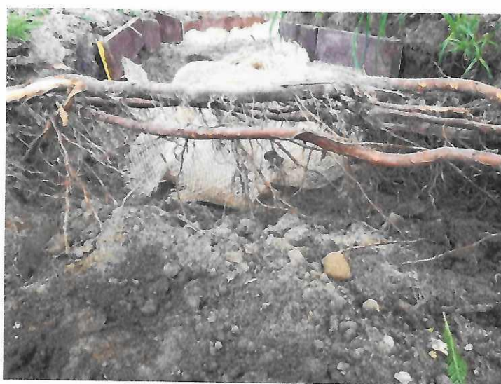
Ryc. 12. Poglądowa fotografia prowadzenia wykopów z zachowaniem korzeni drzew. Prace wykonane zostały niestarannie (odarcie warstwy korowicy i łyka). Korzenie powinny zostać okryte zwilżaną tkaniną jutową jak na Ryc. 5. Źródło: https://siedem-wierzb.pl/korzenie-drzew-podczas-prac-ziemnych-jak-chronic/
