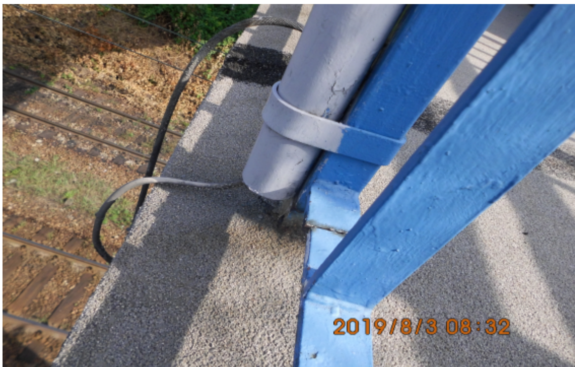
Zdjęcie 3.14 : Nieosłonięty fragment kabla oświetlenia
