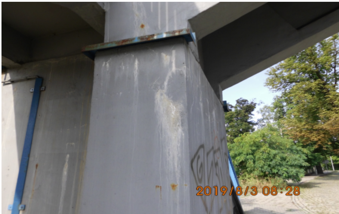
Zdjęcie 3.9 : Zacieki na skutek korozji osłon okapów stalowych.
