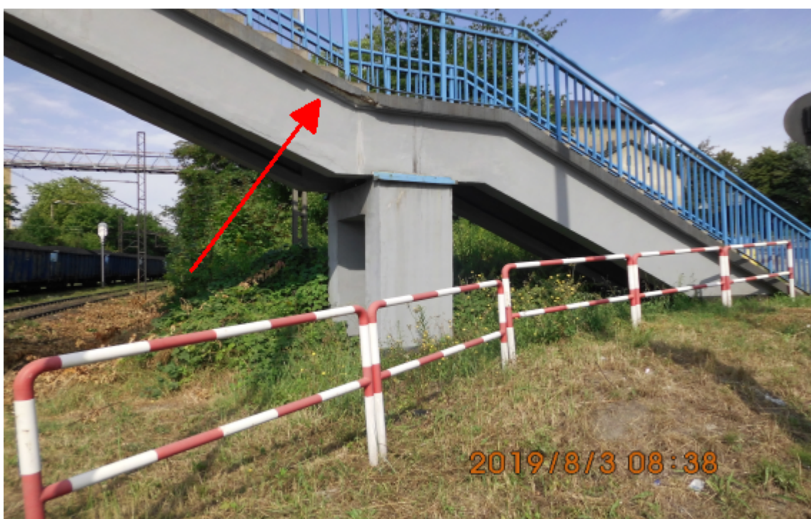
Zdjęcie nr 3.6 : Filar wspierający schody. Strzałką pokazano wykruszenie betonu gzymsu schodów.
