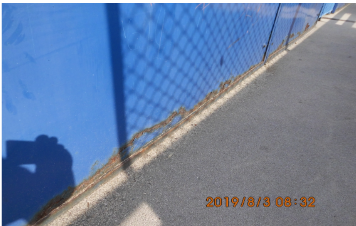
Zdjęcie 3.10 : Korozja osłon przeciwporażeńowych przy balustradach
