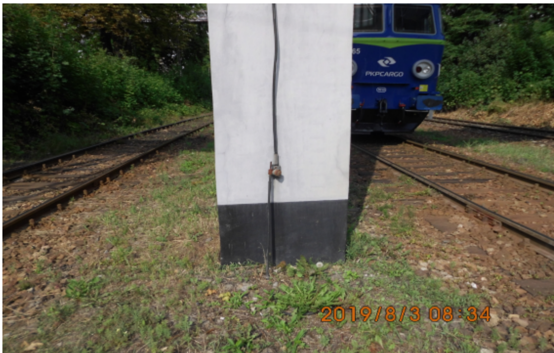
Zdjęcie 3.11 : Złącze pomiarowe uziemienia
