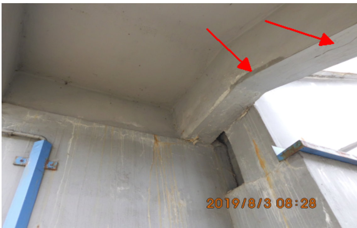
Zdjęcie 3.5 Widok konstrukcji kładki od spodu i fragmentu filara. Strzałkami pokazano spękania otuliny zbrojenia.
