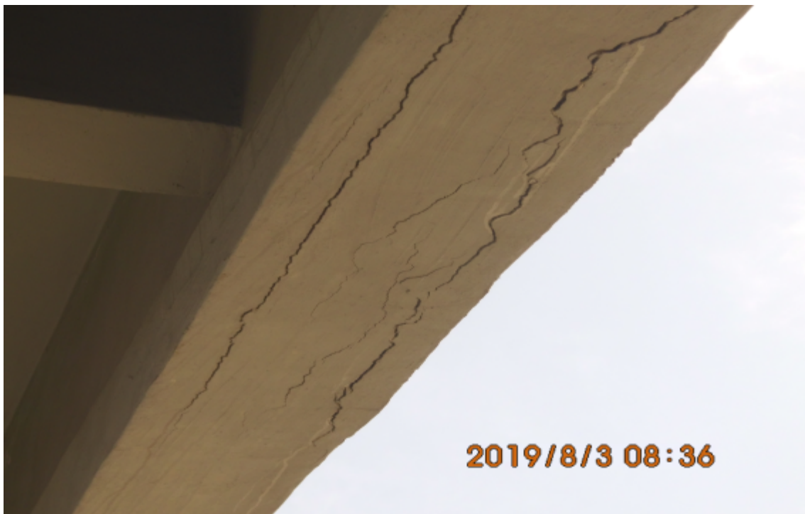
Zdjęcie 3.13 : Pęknięcia pod dźwigarem głównym
