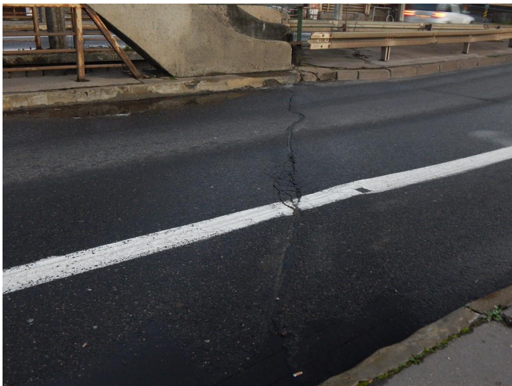
Fot. 4. Uszkodzenie j.w. ( wyniesiona nawierzchnia wraz z krawężnikiem )
