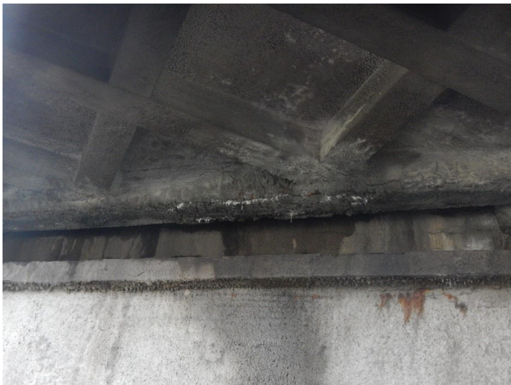
Fot. 15. Uszkodzenia j.w.
