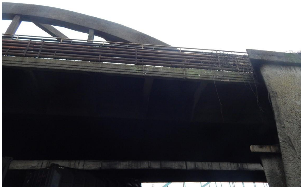
Fot. 11. Korozja stali w urządzeniach obcych
