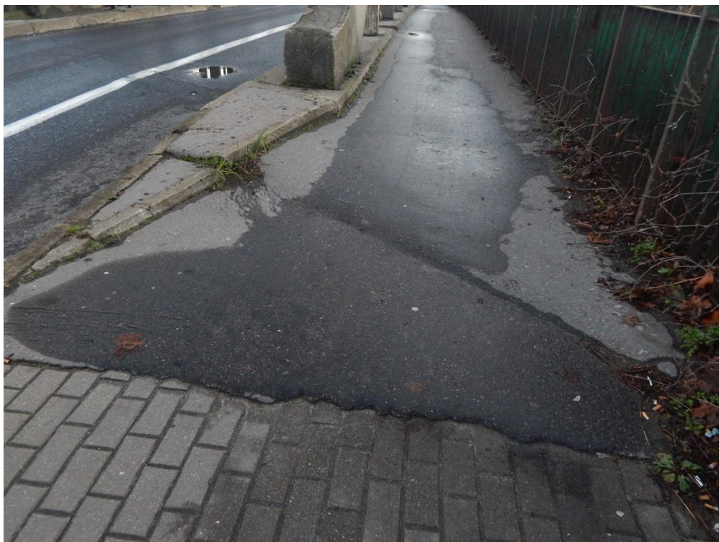
Fot. 1. Deformacja nawierzchni chodników na dojazdach, przemieszczenie krawężników betonowych
