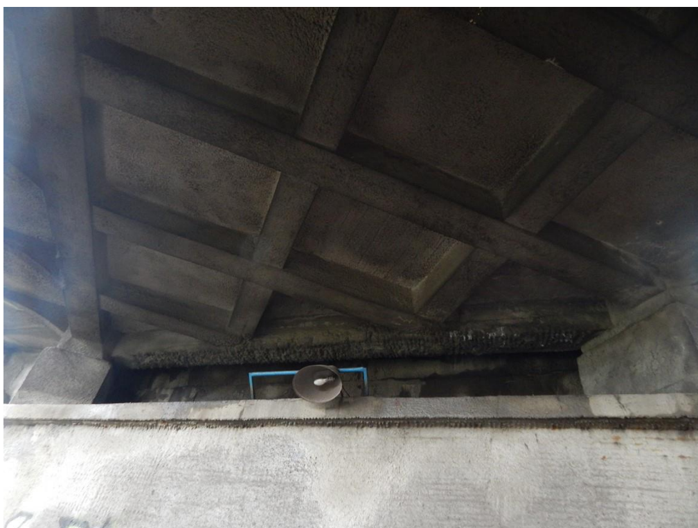
Fot. 20. Uszkodzenia w miejscu dylatacji obiektu
