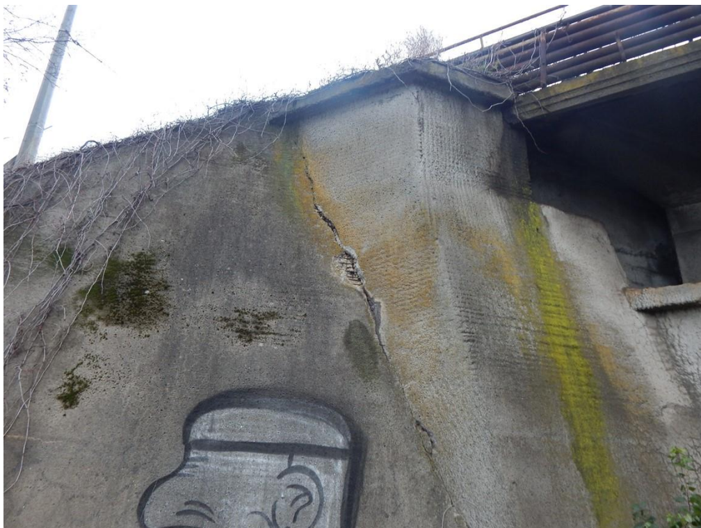
Fot. 17. Ubytki i spękania betonu w skarpach umocnionych, wegetacja betonu i graffiti
