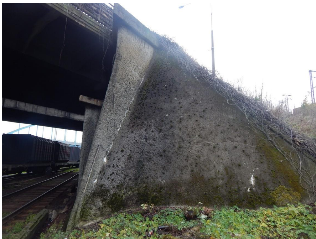
Fot. 12. Wegetacja roślin, rysy, przecieki i osady w stożkach umocnionych
