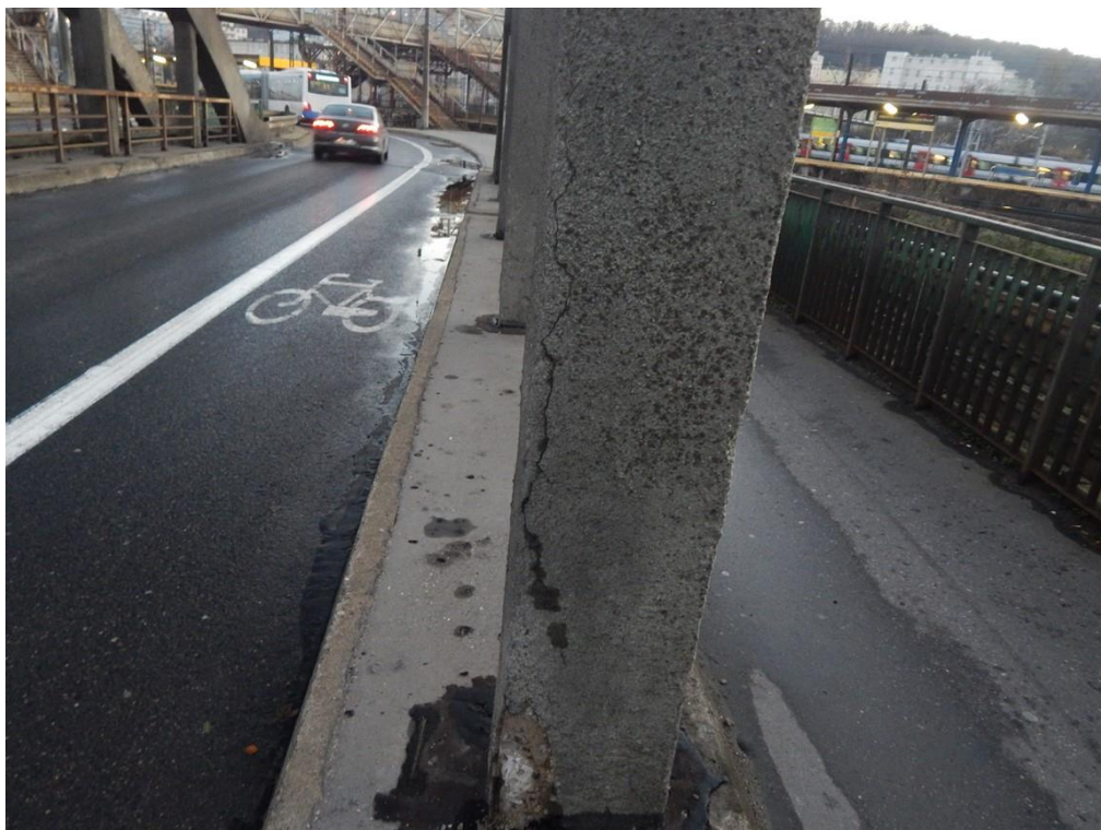
Fot. 7. Spękania i rysy w elementach cięgien
