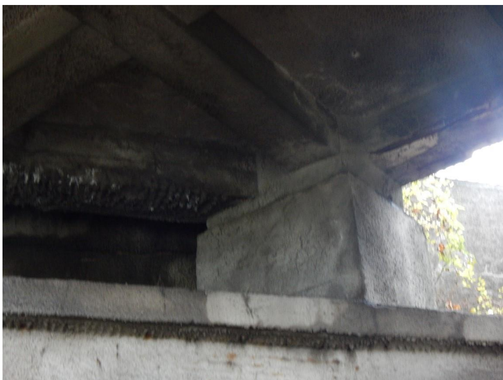
Fot. 18. Rysy i spękania w ciosach podłożyskowych
