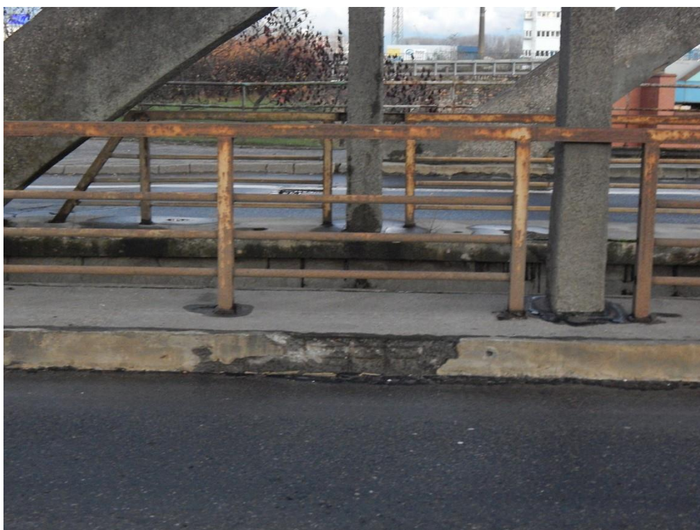
Fot. 2. Ubytki materiału w krawężnikach, korozja balustrad stalowych
