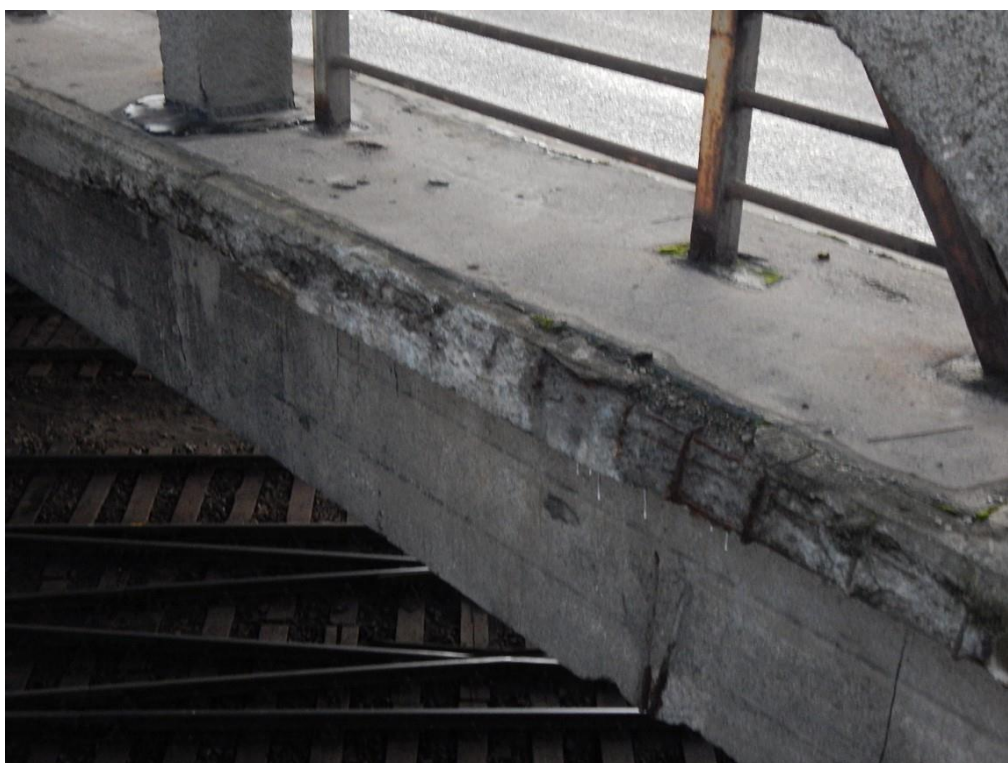
Fot. 10. Ubytki betonu, rysy, osady i przecieki oraz korozja prętów zbrojeniowych w gzymsach
