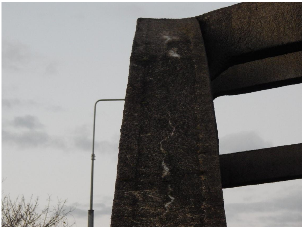
Fot. 9. Spękania i rysy w elementach dźwigarów betonowych
