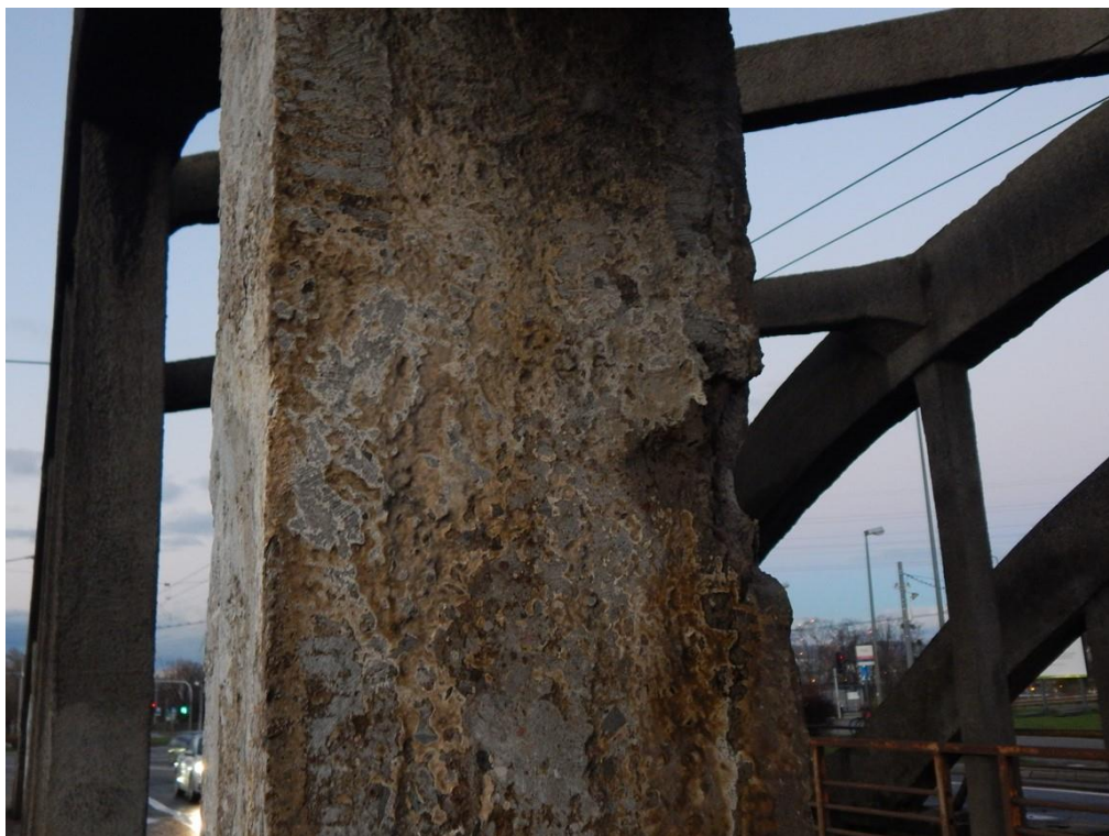
Fot. 8. Uszkodzenia j.w.
