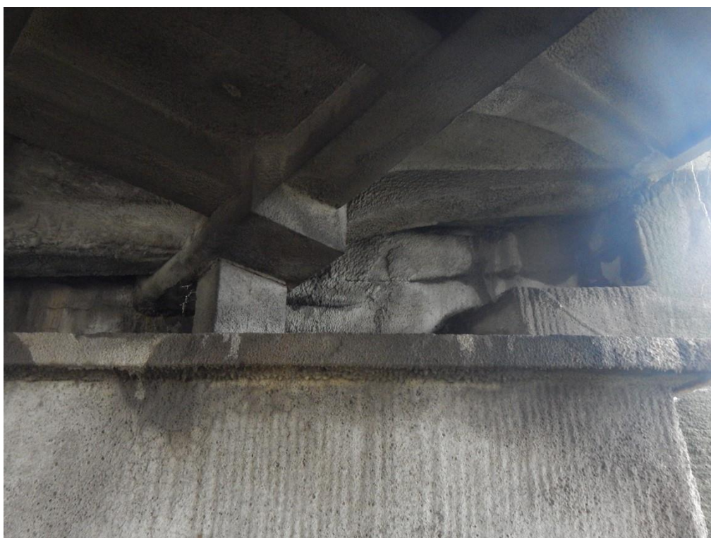
Fot. 16. Uszkodzenia j.w.
