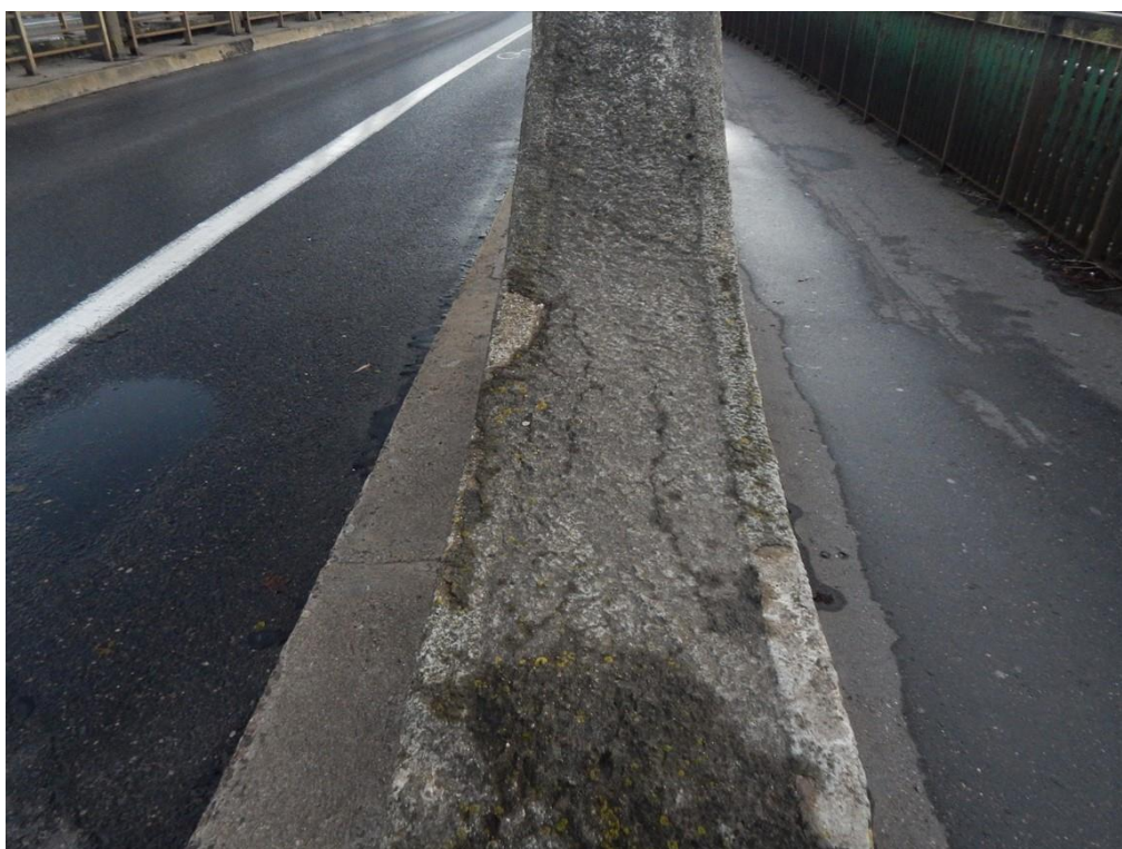
Fot. 6. Uszkodzenia j.w.
