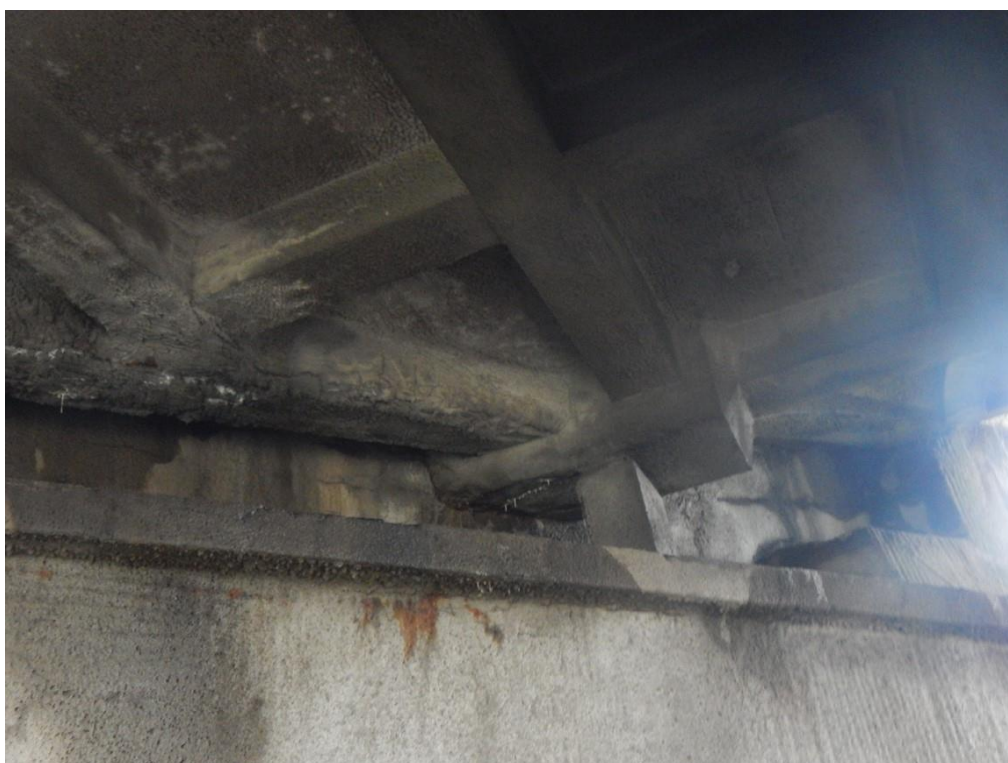
Fot. 14. Korozja i ubytki betonu, przecieki przez dylatację i konstrukcję pomostu
