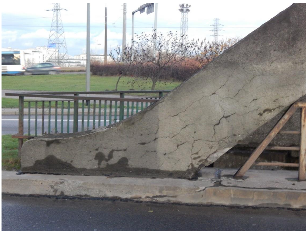
Fot. 5. Spękania i rysy w elementach dźwigarów betonowych
