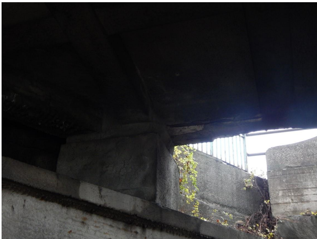
Fot. 19. Uszkodzenia j.w.
