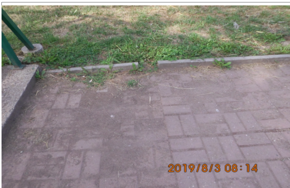
Zdjęcie nr 3.4 : Miejsce powstawania zastoiska wody przed stopniami od strony północnej
