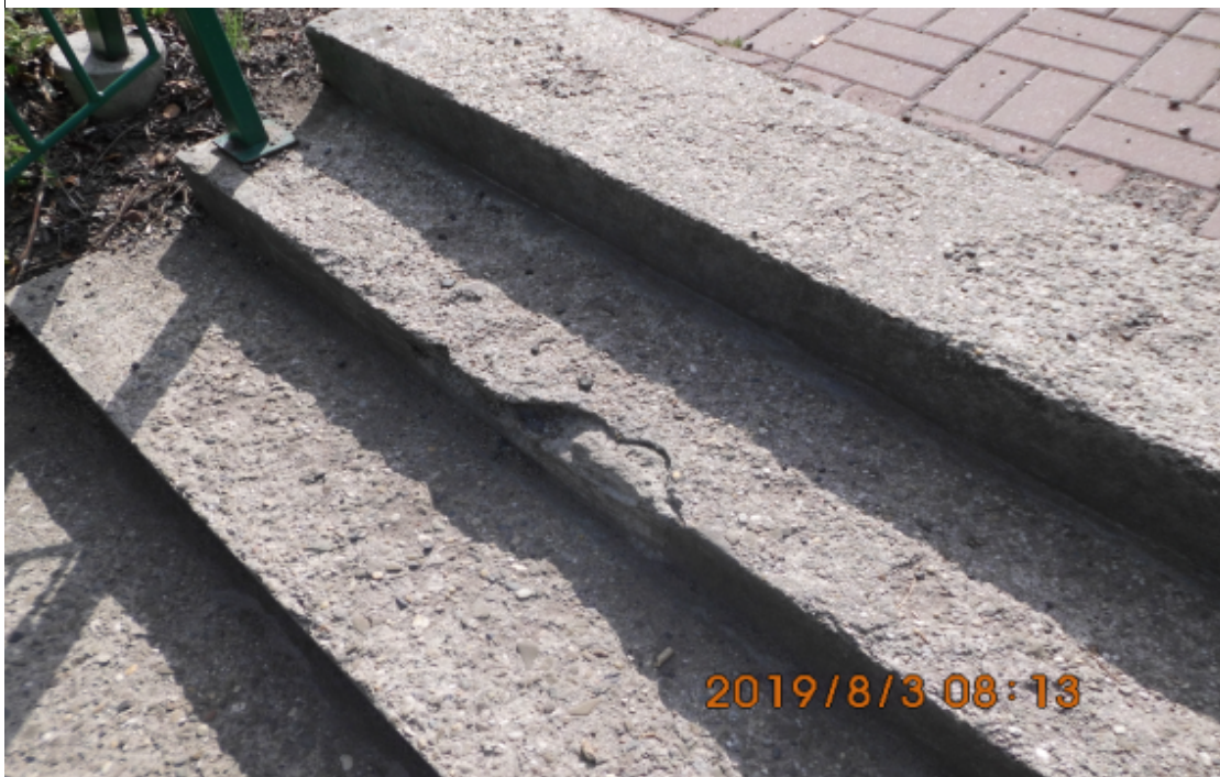
Zdjęcie 3.8: Niewielkie ubytki w betonie schodów
