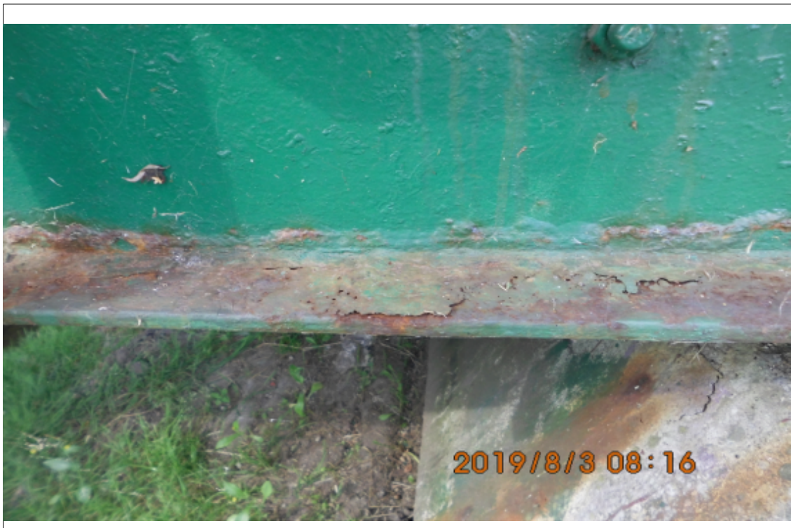
Zdjęcie nr 3.5 : Korozja dźwigara konstrukcji nośnej
