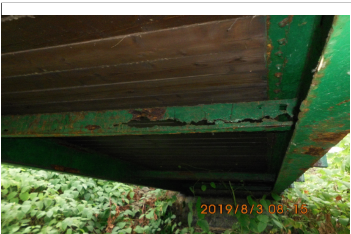
Zdjęcie nr 3.6 : Przesło kładki od spodu, Wymienić przerdzewiałe stężenie poprzeczne
